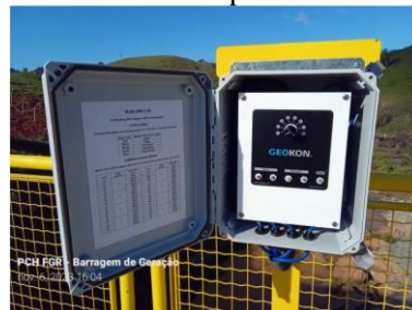
Figura 14. Cabine de leitura da instrumentação instalada
