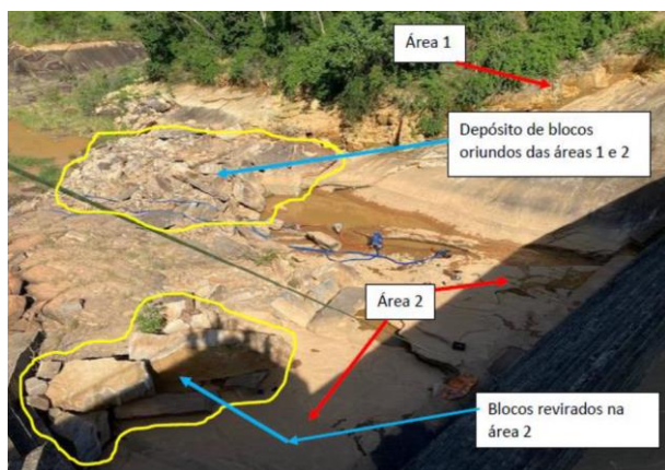
Figura 2. Aspecto da área a jusante com blocos removidos.
