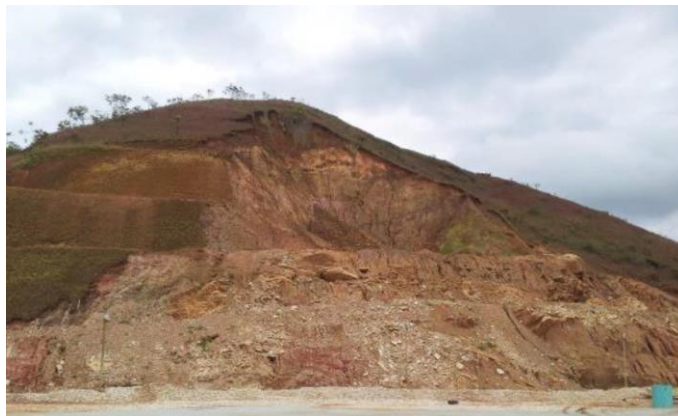
Figura 5. Registro fotográfico de 2012 – pós ruptura
