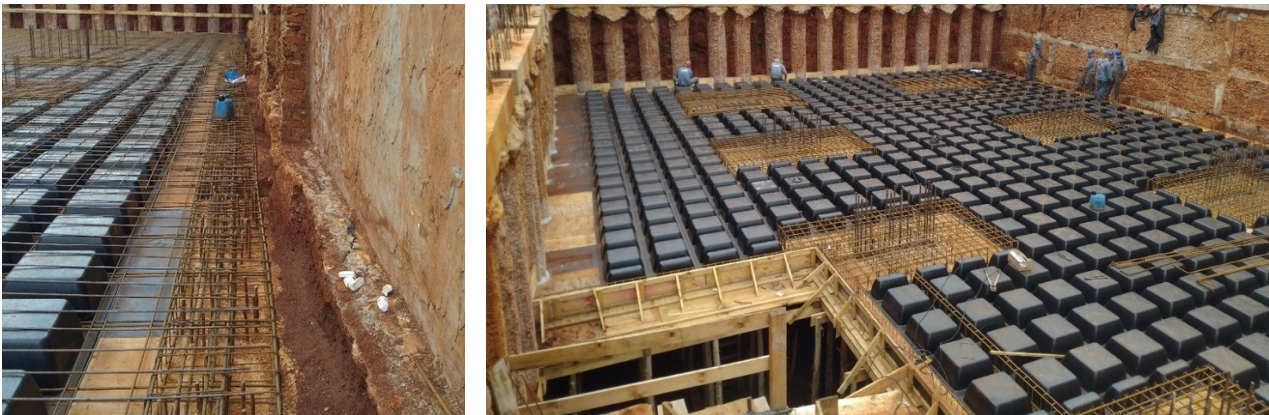
Figura 8. À esquerda de piso da garagem inferior: primeiro apoio das cortinas, onde acaba a fixa e inicia o comprimento livre. À direita preparação para concretagem do apoio intermediário: laje de piso da garagem 1. Fonte: Camerini e Serraglio (2022).
