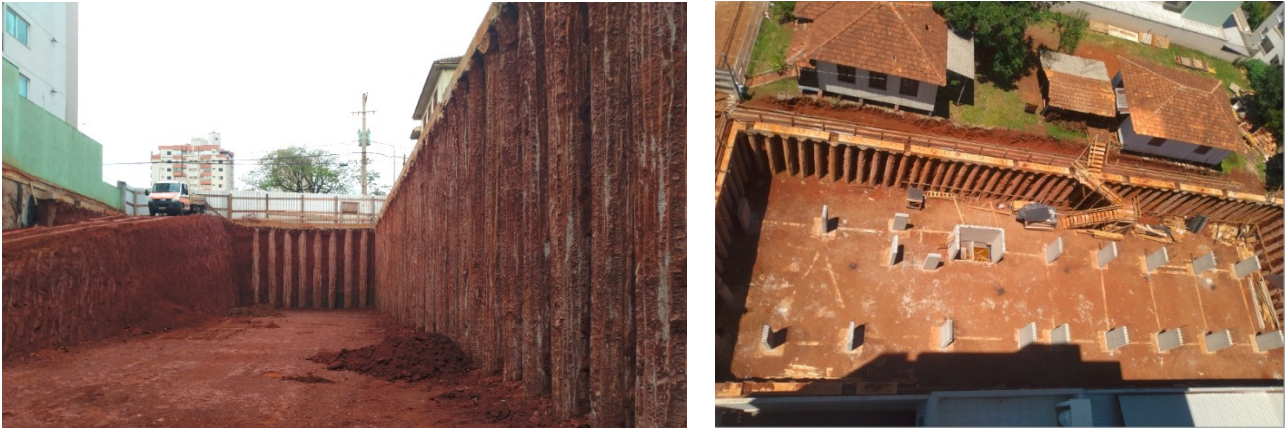
Figura 7. À esquerda a escavação do terreno, permanecendo as estacas enterradas apenas comprimento de ficha de projeto, e à direita o início dos pilares da mesoestrutura sobre os tubulões. Fonte: Camerini e Serraglio (2022).
