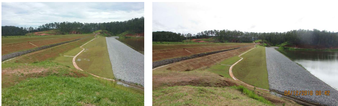
Figura 9. Inspeção na estrutura realizada em dezembro de 2018 onde observa-se o aporte d'água a jusante da estrutura.
