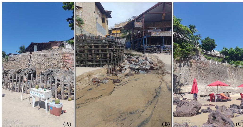
Figura 3. Estruturas de contenção existentes na Praia do Centro; (A) Muro de arrimo fissurado; (B) Enrocamento com presença de intensificação do processo erosivo; (C) Estrutura fissurada devido ao esforço gravitacional após o deslocamento dos sedimentos de sua base.
