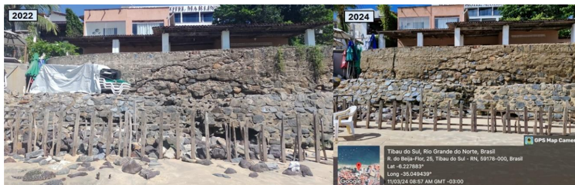
Figura 5. Muro de arrimo fissurado com enrocamento em gaiola de madeira.
