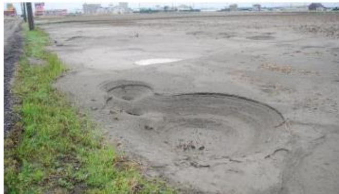
Figura 1. Liquefação em solo arenoso (Fonte: Amanda Fuccio (2019)).
