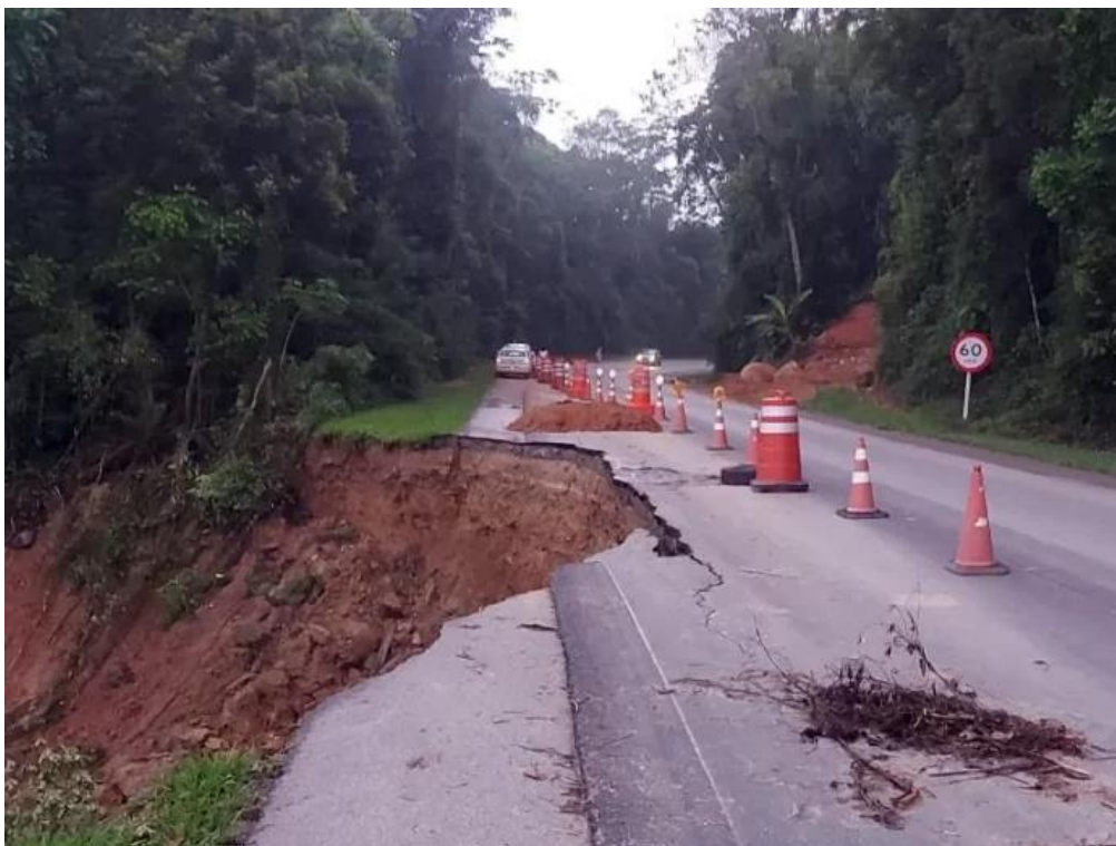
Figura 3. Movimento de massa na BR-282, em Águas Mornas. Fonte: CSC, 2022.
