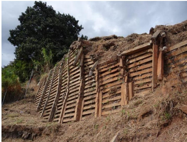
Figura 6. Muro tipo Crib-Wall após a ruptura do talude (O autor, Julho/2018).
