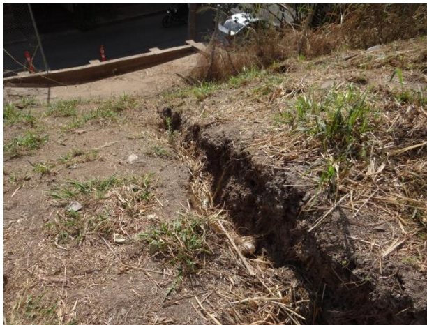
Figura 7. Trinca longitudinal no terreno. (O autor, Julho/2018).
