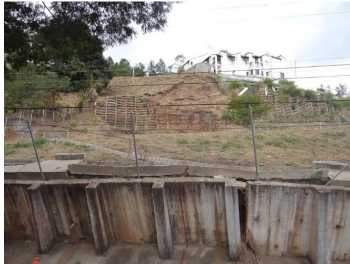
Figura 3. Muro de concreto armado semi-tombado na base da encosta e muro Crib-Wall danificado ao fundo da imagem (O autor, Julho/2018).
