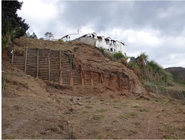
Figura 5. Muro tipo Crib-Wall após a ruptura do talude (O autor, Julho/2018).
