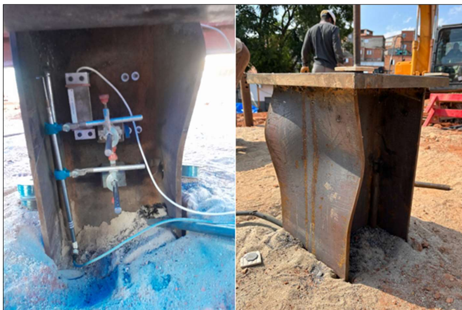
Figura 7. Ruptura estrutural do perfil Grau 60.
