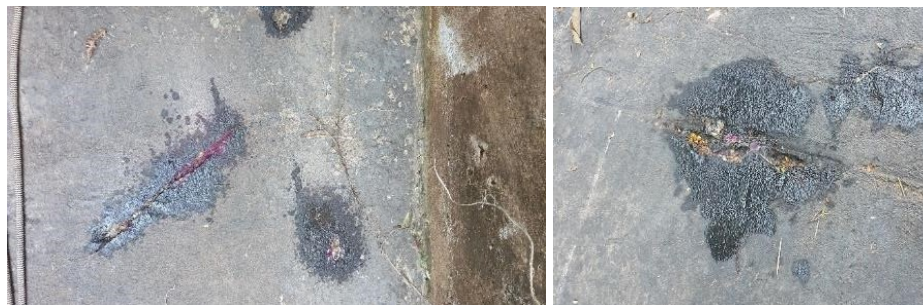
Figura 5. Execução do teste de carbonatação na estrutura do vertedouro, com a utilização da solução de fenolftaleína.
