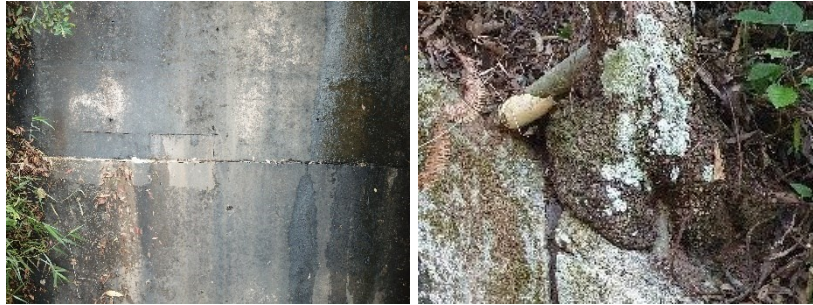
Figura 3. Junta de dilatação danificada (esquerda), e observada presença de vegetação em crescimento.
