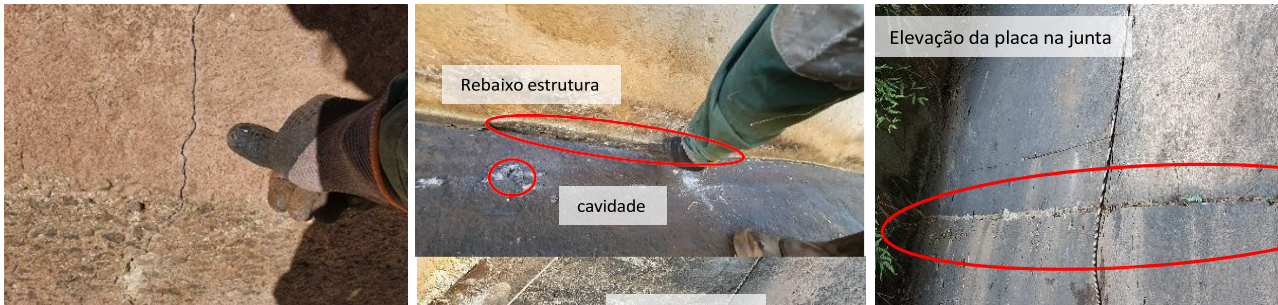
Figura 1. Verificada trinca (esquerda), rebaixamento da estrutura (central) e elevação do painel na junta de dilatação (direita).
