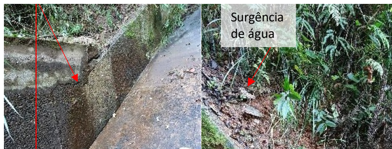
Figura 2. Observado surgência d'água representando saturação do maciço nas paredes laterais da rampa do vertedouro.
