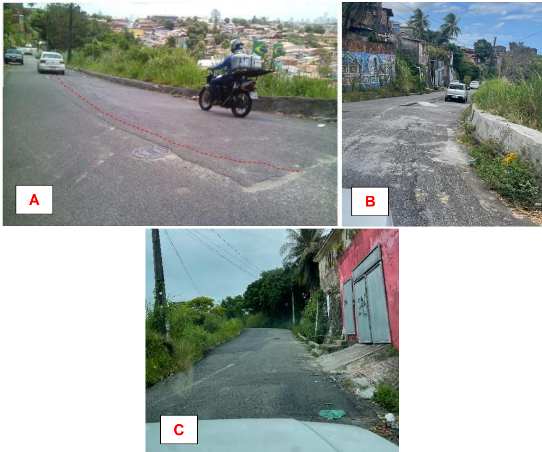
Figura 6. Histórico da trinca no talude de estudo.
