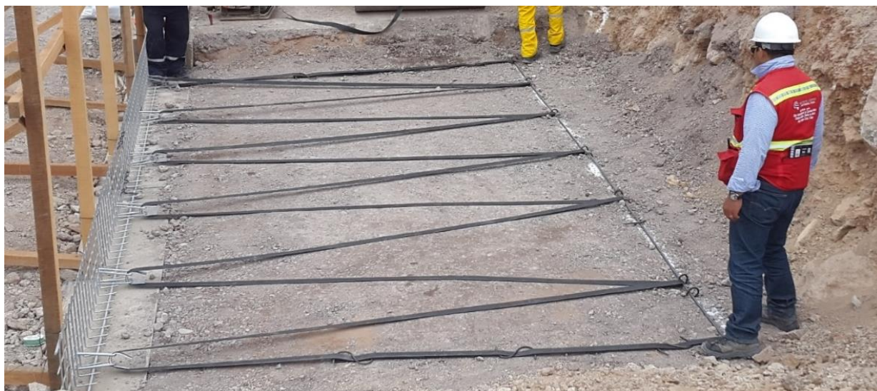
Figura 11. Disposição dos reforços geossintéticos primários no corpo do aterro reforçado. FONTE: Freyssinet Terra Armada Perú S.A.C.
