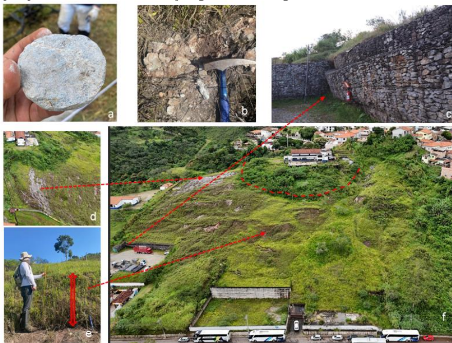
Figura 2 – a) Detalhe do filito prateado; b) afloramento do filito em processo inicial empastilhamento; c) muro de gabião tombado pelo rastejo; d) afloramento de filito exposto em degrau de abatimento. e) Degráu de abatimento com mais de 1 m de amplitude; f) Foto oblíqua do talude, onde se observa a escola Padre Carmélio fundada em aterro (delimitado pela linha tracejada vermelha). Observar degraus de abatimento, indicadores de deformação retrogressiva, mais abundantes a montante de grandes cortes na base do talude.
