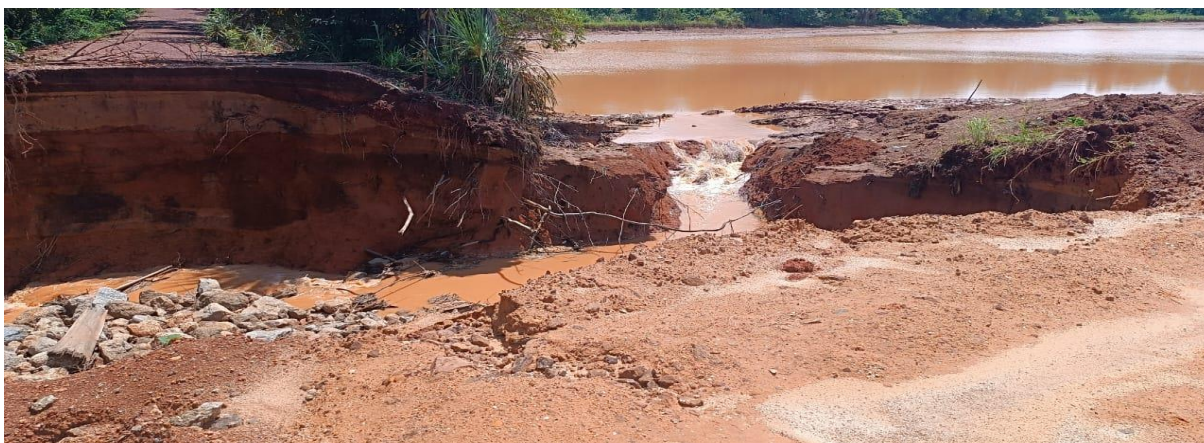
Figura 3.4 - Falha da barragem no ponto de erosão 1.
